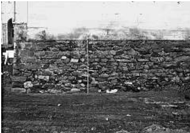
Abb. 21. Ascona, Cast. dei Griglioni. Südwestturm (D). Fundament von Turm und Kurtine freigelegt (1967).
